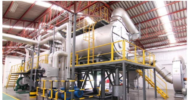
หม้อต้มน้ำร้อน(Boiler)
